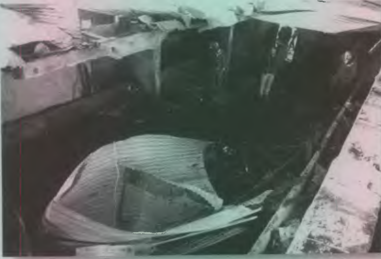
Resim 35: Yangında çatısı çökmüş bir ahır
